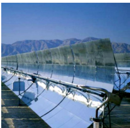
345 MW Solar Troughs, USA
